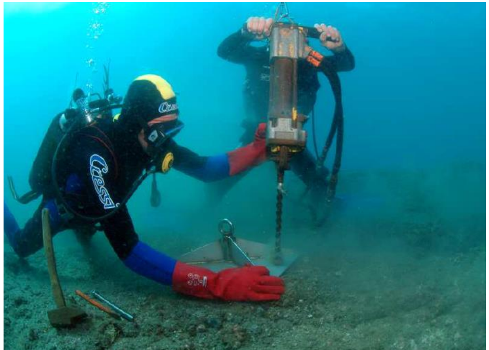
Perçage de la roche avec perforateur hydraulique pour scellement des tirants (Neptune Environnement)
